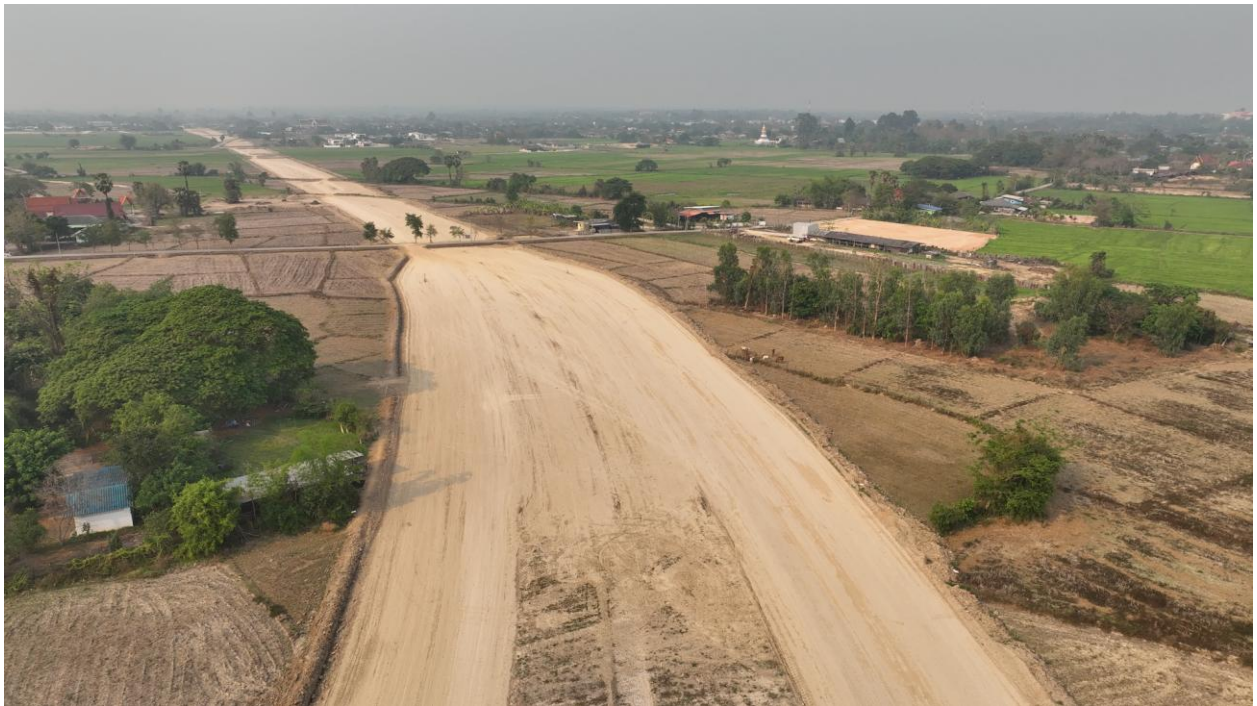
รูปที่ 5-3 ช่วง กม.1+000 (พื้นที่ก่อสร้างถนนสายแยก ทล.11 ถึง ทล.1 อ.เมือง จ.ลำปาง ตอนที่ 1 อยู่ระหว่างดำเนินการก่อสร้าง)
